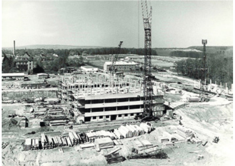
Großbaustelle Großkrankenhaus: Ein Blick auf das Baugeschehen von Südosten aus gesehen. Im Hintergrund links die Kinderklinik.
