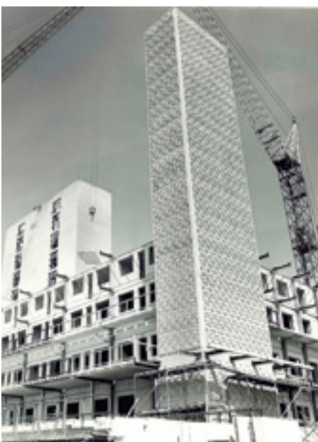
Das Bettenhaus aus der nordwestlichen Perspektive – der dekorativ verkleidete Schacht fürs Treppenhaus steht bereits.
