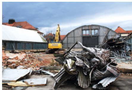
Fein säuberlich wurden die Baumaterialien bereits während des Abrisses getrennt. Foto: Reuther
