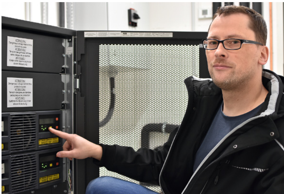
Fachingenieur Henrik Striegler (SCT) am Herzstück der unterbrechungsfreien Stromversorgung, die für eine Stabilität des Rechenzentrums unabdingbar ist. Foto: Merkel
