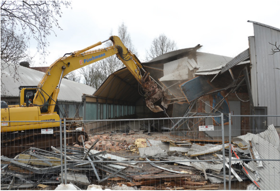
Mit großem Gerät rückten die Kollegen des Abrissunternehmens seit dem 17. Februar den beiden Hallen zu Leibe.
