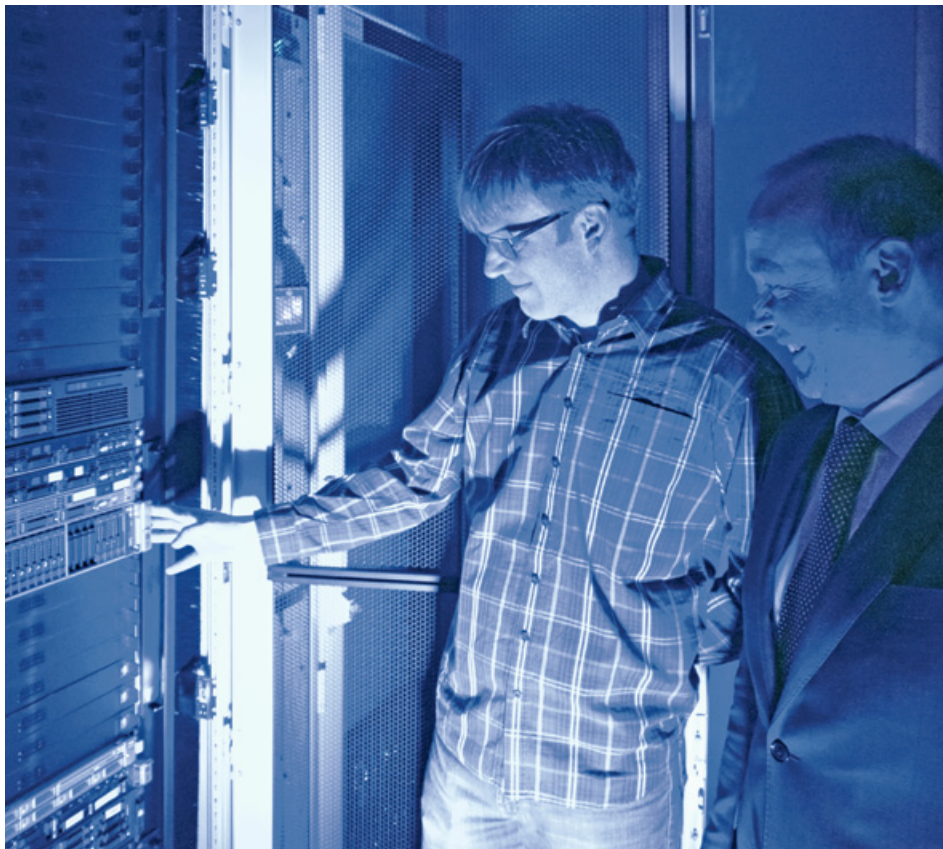
Dr. rer. nat. Frank Nüßler (Leiter des Bereichs Informatik; r.) und Systemadministrator Steffen Wasick bei einer Hardware-Prüfung im neuen Rechenzentrum des Klinikums. Foto: Kreißig
